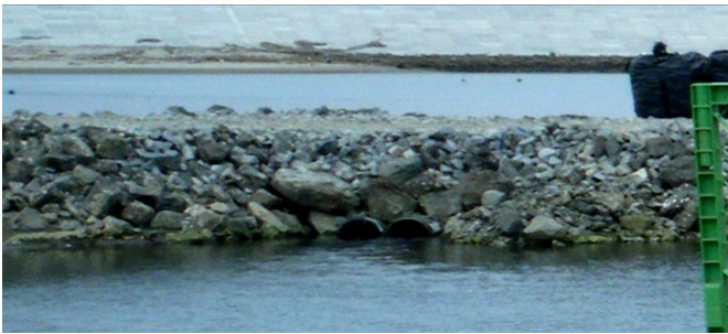
(Fig.1 通水部のパイプ)
